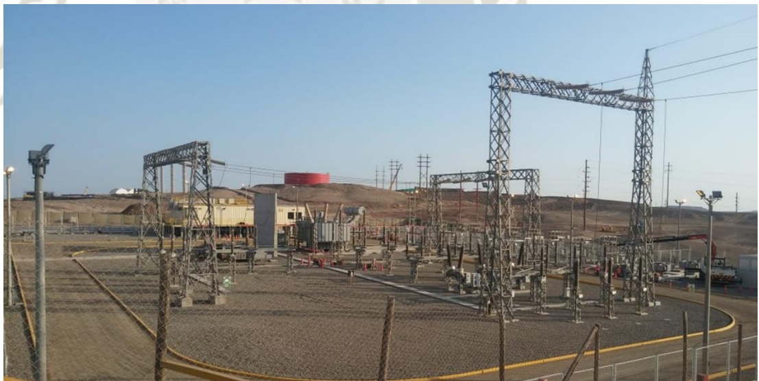
Figura 10: Subestación Proyecto Mina
