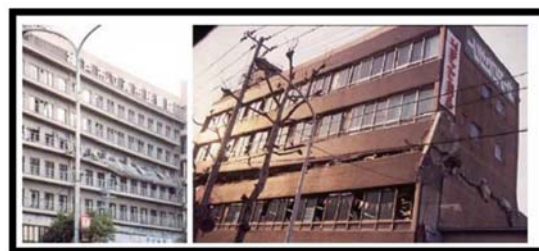
Figura 3. 13 Colapso de pisos Intermedios debido a cambio brusco de la rigidez y resistencia de pilares. (Fardis N.F. 2009)
