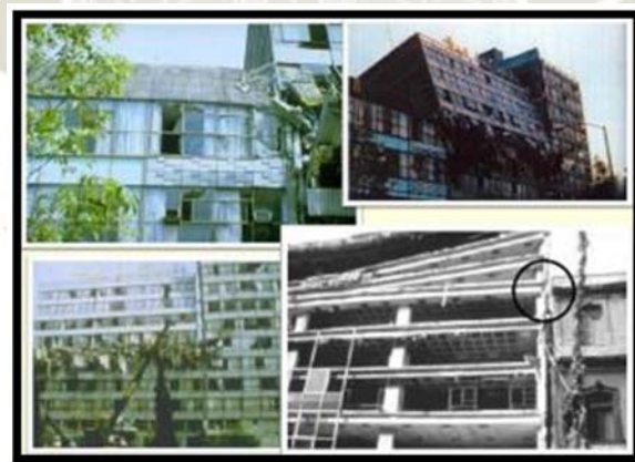
Figura 3. 15 Falta de Separación Sísmica entre Edificios. (CIGIR, 2009)
