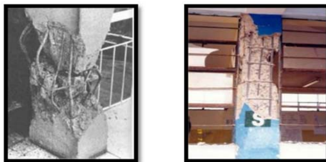
Figura 3. 11 Falla por compresión en Columnas por falta de Confinamiento (Ángel San Bartolomé, 1998)
