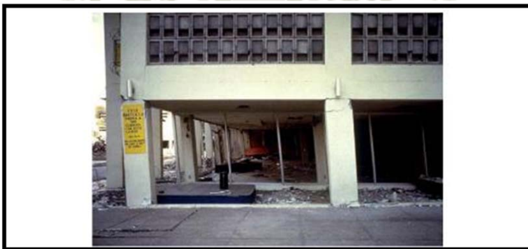
Figura 3. 19 Efecto de piso blando en Edificio en Venezuela. (CIGIR, 2009)
