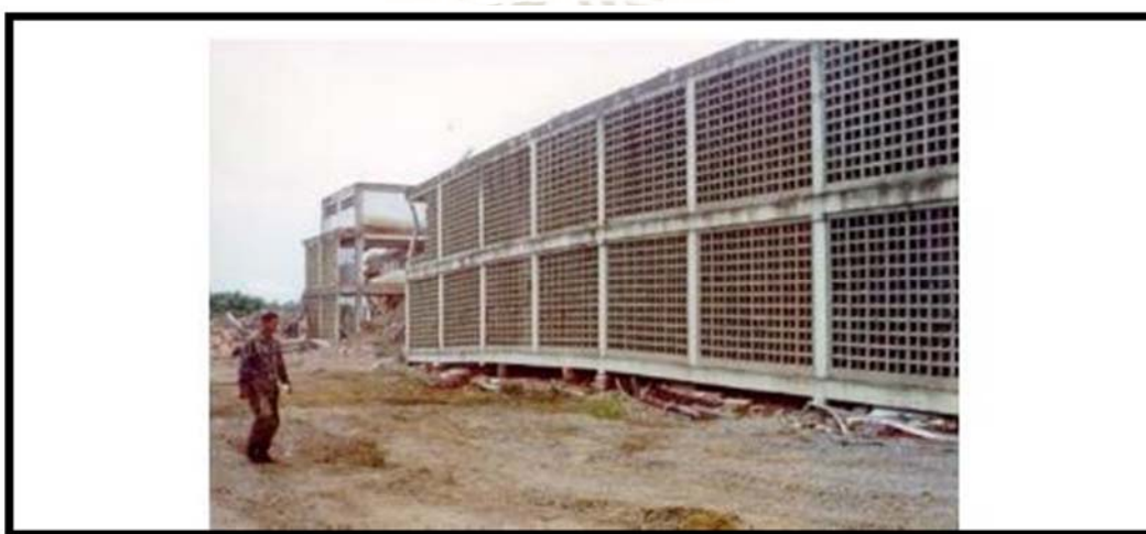
Figura 3. 20 Colapso total de la planta baja del edificio. (Liceo Raimundo Martínez, 1997)
