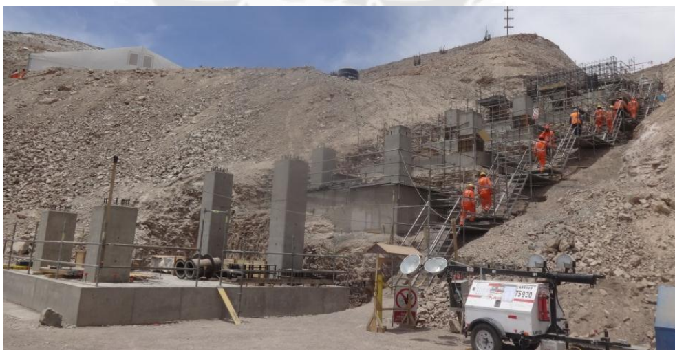
Foto 38 Estructuras de soporte en cascada
