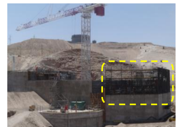
Interferencia con Grúa
