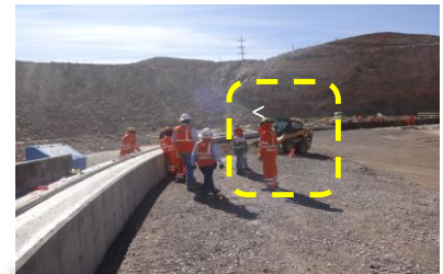
Paralización por mal operación de Eq.
