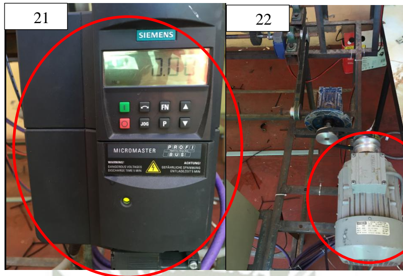
Figura 5.1.3. Variador profibus 0310-VDF-0001 y motor de molino 0310-ML-0001-M1. Fuente: Propia
