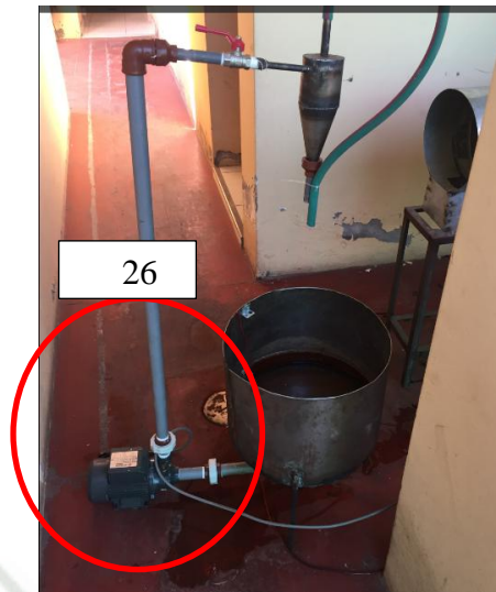
Figura 5.1.5. Bomba de sistema de hidrociclón 0310-PP-0001 con motor 0310-PP-0001-M1. Fuente: Propia
