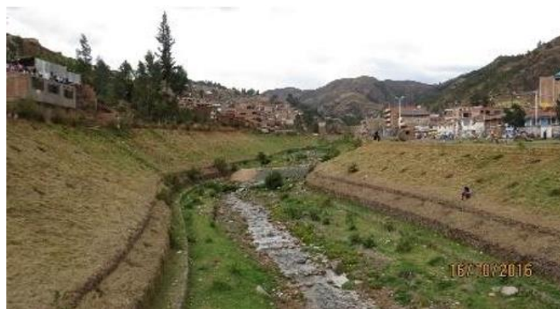
Figura 10. Encauzamiento, después de la implementación del PROGAISH
