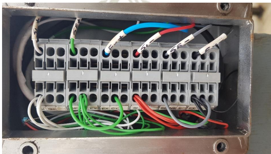
Figura 64. Caja de conexiones de marca Siemens para celdas de pesaje (Planta Prillex, 2018)
