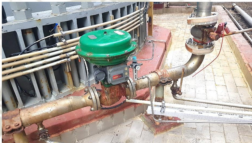
Figura 51. Válvula neumática controladora de ácido (Planta Prillex, 2018)
