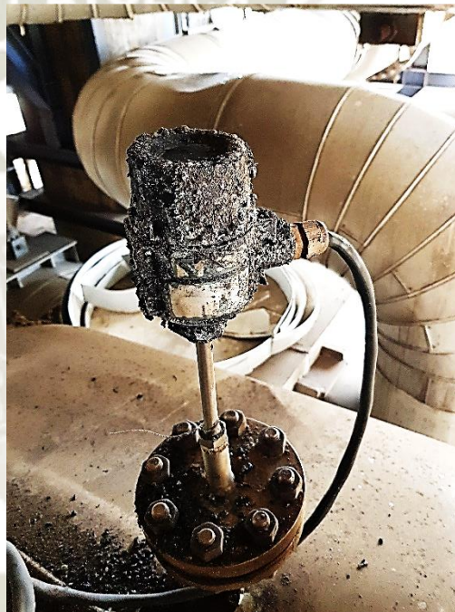
Figura 41. Transmisor de temperatura deteriorado por gases nitrosos (Planta Prillex, 2017)
