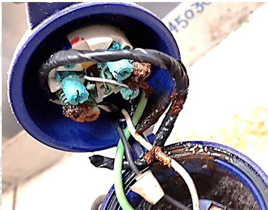
Figura 36. Bornes corroídos por fisura en Thermowell de un sensor de Temperatura (Planta Prillex, 2018)
