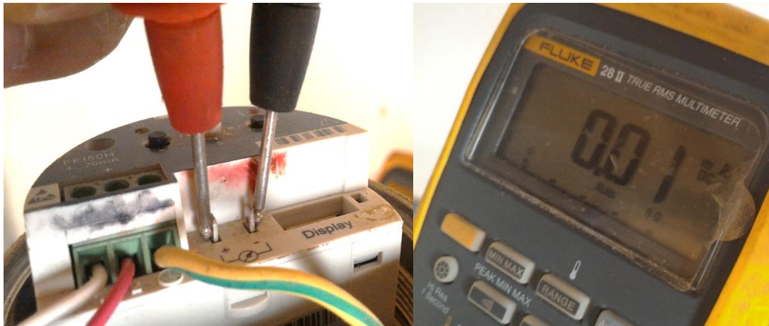
Figura 18. Revisión de salida de corriente de un transmisor por medio de puntos de medición (Planta Rio Loa, 2016)
