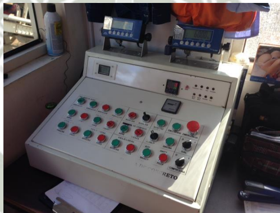
Fig. 2.14 Caseta de control con mandos manuales.
