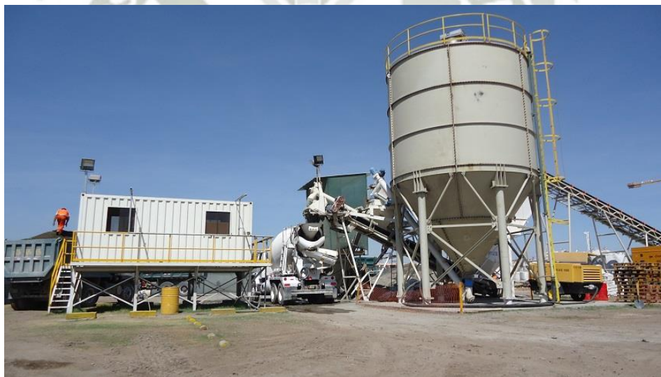
Fig. 2.16 Silo principal de cemento.
