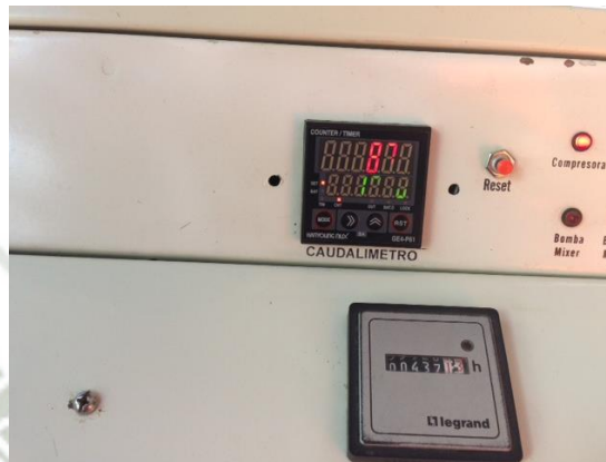
Fig. 2.19 Caudalímetro instalado en el panel del operador.
