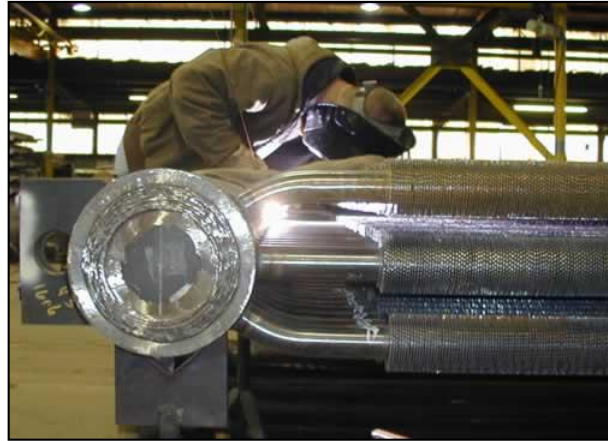
Figura II-24 Tubos Aletados del HRSG
