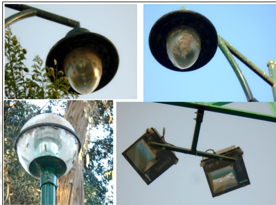
Foto 11: Estado Luminarias Exteriores
