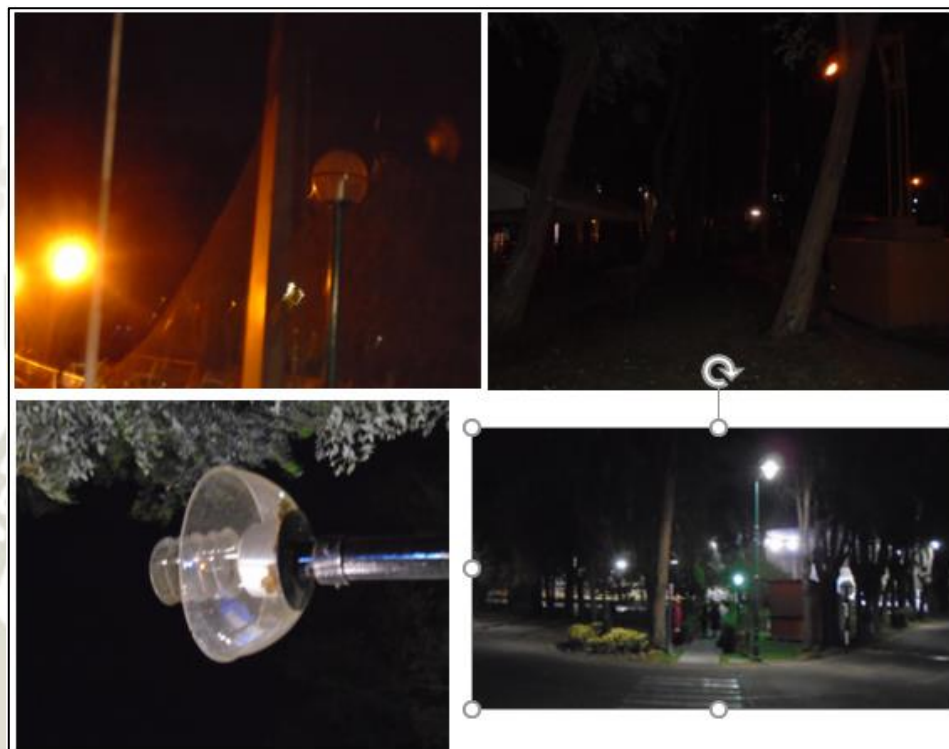
Foto 8: Deficiencias en Iluminación
