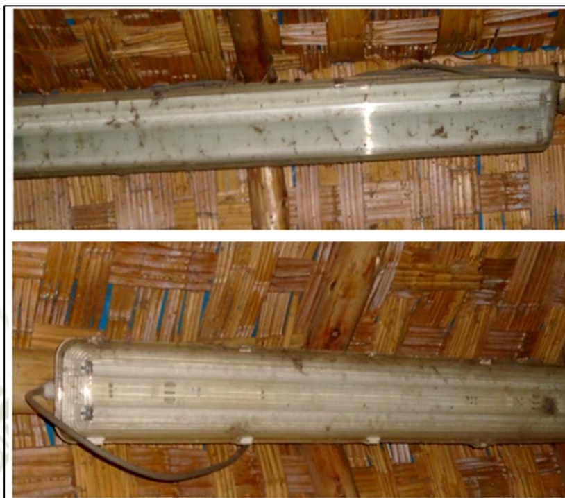
Foto 10: Estado Luminarias Interiores
