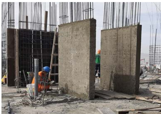
FIG 3: Placa vaciada con un acabado de superficie no uniforme y cuya base está siendo resanada por un obrero.
