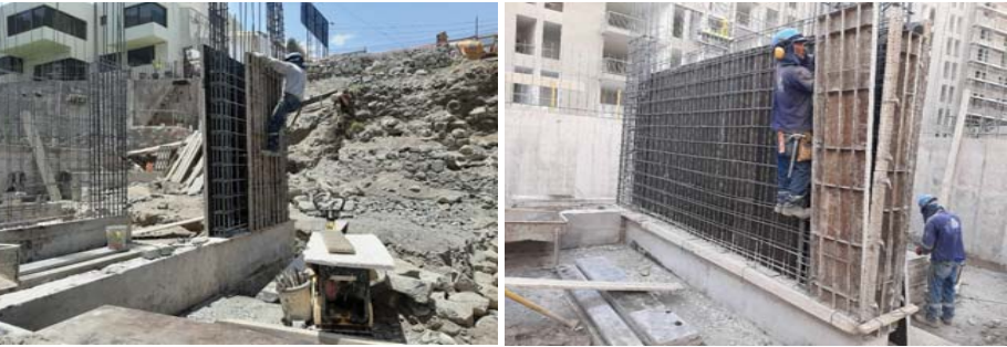
FIG 3: Obrero perteneciente al personal en estudio, y maestro encargado de los obreros, subido en una placa para poder encofrarla pero sin hacer uso de algún andamio ni arnés de seguridad. FIG 4: Obrero perteneciente al personal en estudio colocando una plancha en una placa donde se puede ver con claridad la base de encofrado colocada por tratarse de un muro de sótano.
