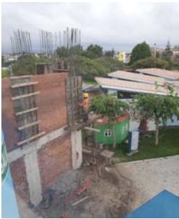
FIG 4: Obrero perteneciente al personal en estudio, encofrando la cara en borde de la placa P-2 parado sobre una plataforma de borde que carece de barandas de seguridad.
