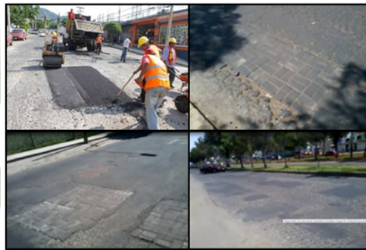
Imagen 2.3.11.1.6.1 Trabajos de bacheo superficiales necesarios en las zonas de estudio (EP)
