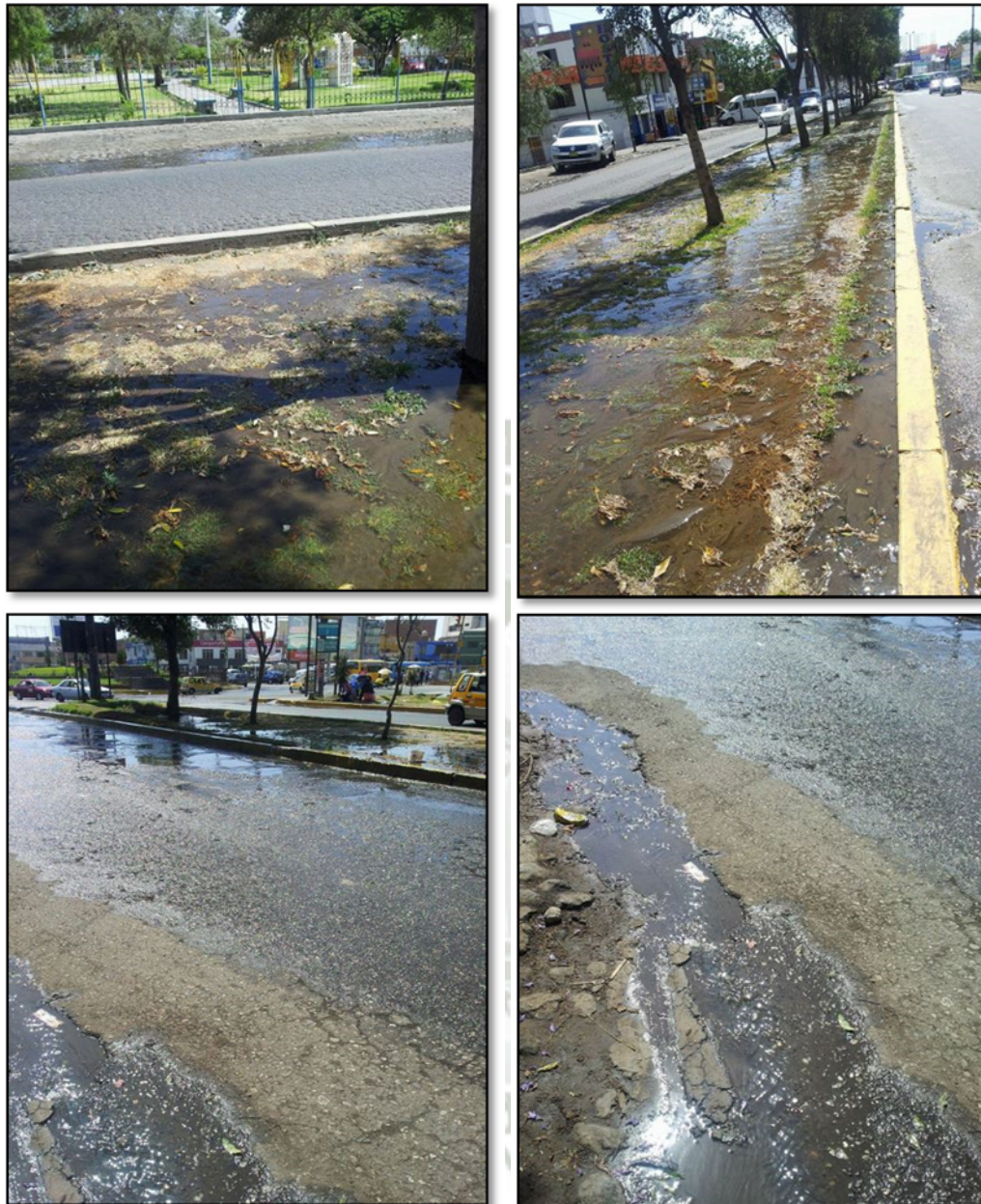
Registro 2.3.15.1 Pavimentos flexibles en prolongación Andrés Avelino Cáceres, tramo 1, bajo el efecto destructivo del agua (EP)
