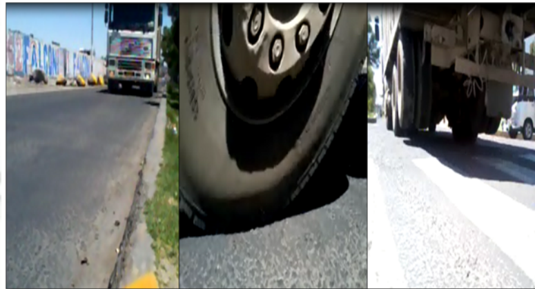
Imagen 4.2.13.1.1 Camión entrega carga, deformación y esfuerzos al pavimento flexible avenida prolongación Andrés Avelino Cáceres (EP)
