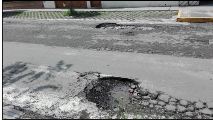
Imagen 2.3.11.1.10.1 Ejemplo de condición de un flexible para reconstrucción, avenida Hartley, tramo 3 en el sentido ascendente (EP)
