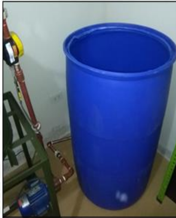
GRÁFICO N° 42. TANQUE DE RECEPCIÓN.
