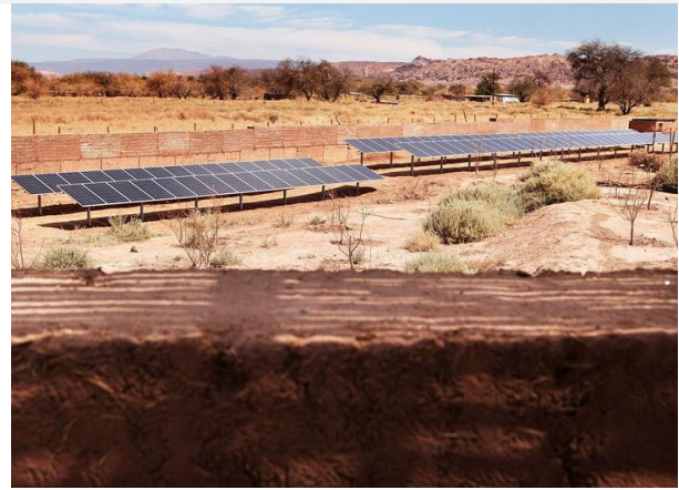
IMAGEN N°23 SISTEMA HIBRIDO DE GENERACION DE ELECTRICIDAD
