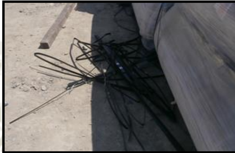
Figura 52: Zunchos no dispuestos en las zonas de acopio asignadas.
