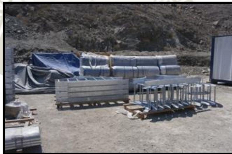
Figura 40: Almacén Skanska sin áreas señalizadas ni demarcadas.
