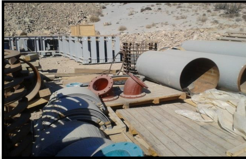
Figura 42: Almacén JJC sin orden ni limpieza.
