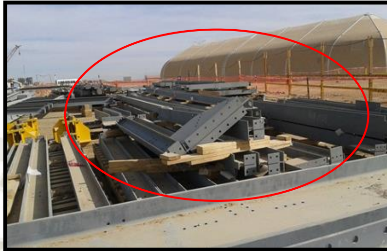
Figura 19: Soportes laterales apilados en forma desordenada.
