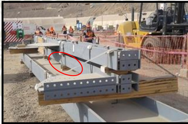
Figura 15: Viga con 02 de sus 04 puntos de apoyo en el aire.
