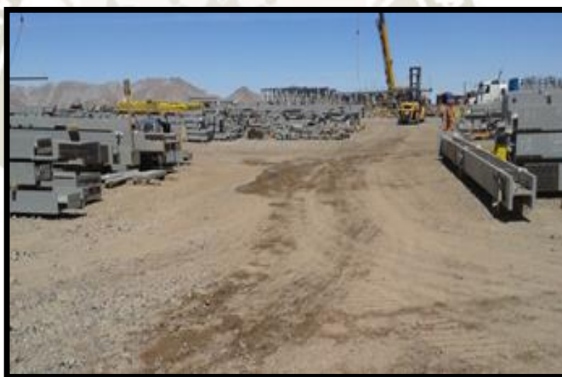
Figura 38: SAT-8 sin áreas señalizadas ni demarcadas.
