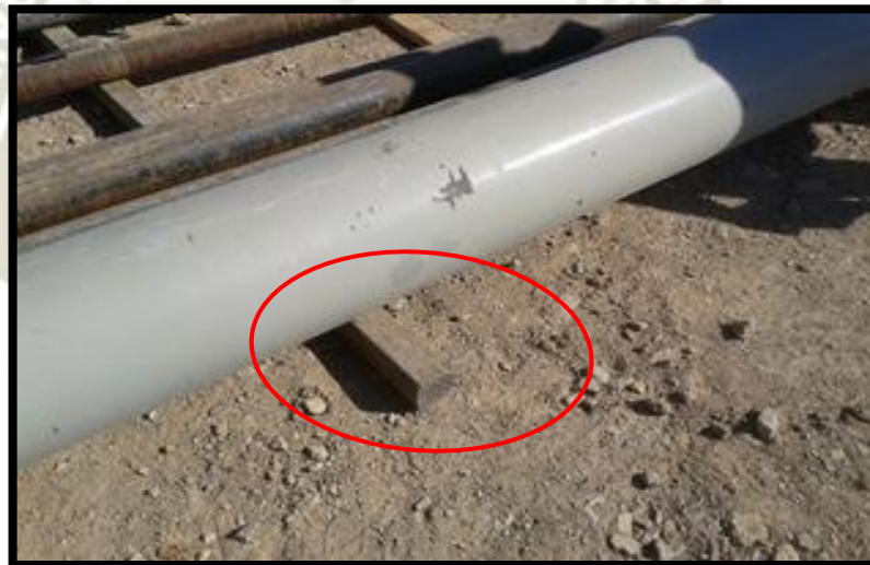
Figura 21: Tubería apilada sin tacos ni cuñas.
