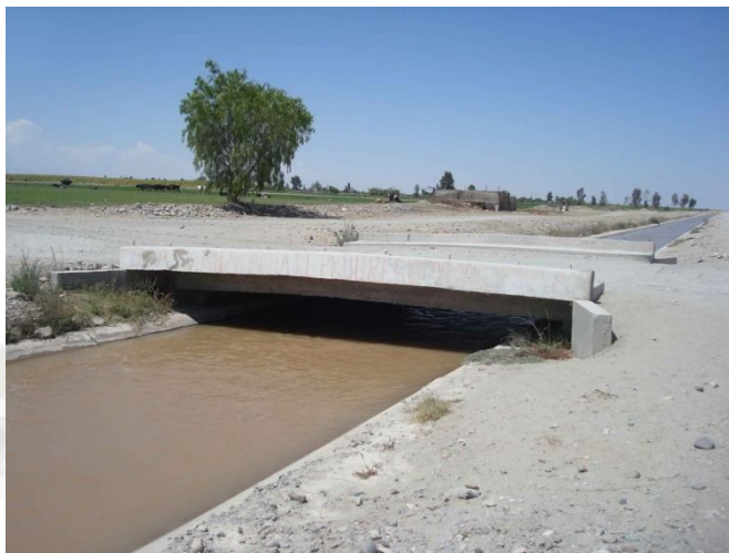
Fig. N°11.4: Pontón en estado regular
