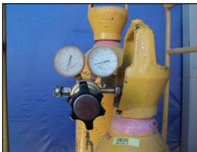
Manómetro regulador de Nitrógeno Figura N° 97
