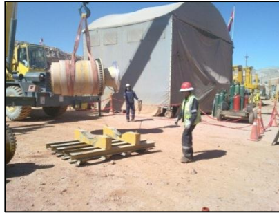
Desmontaje de Mando Final Figura N° 67
