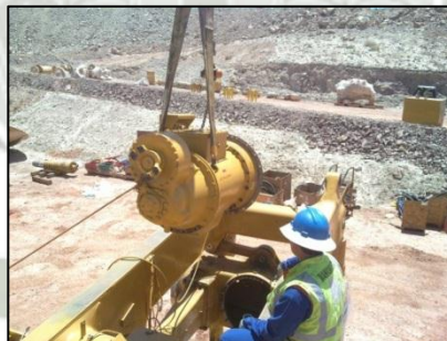
Instalación de Transmisión Figura N° 44
