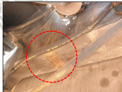
Fisura en larguero izquierdo Fig. N° 5
