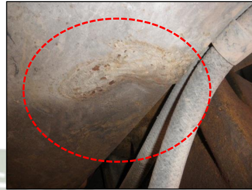
Fisura en larguero derecho Fig. N° 7
