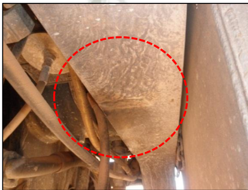
Fisura en larguero izquierdo Fig. N° 25
