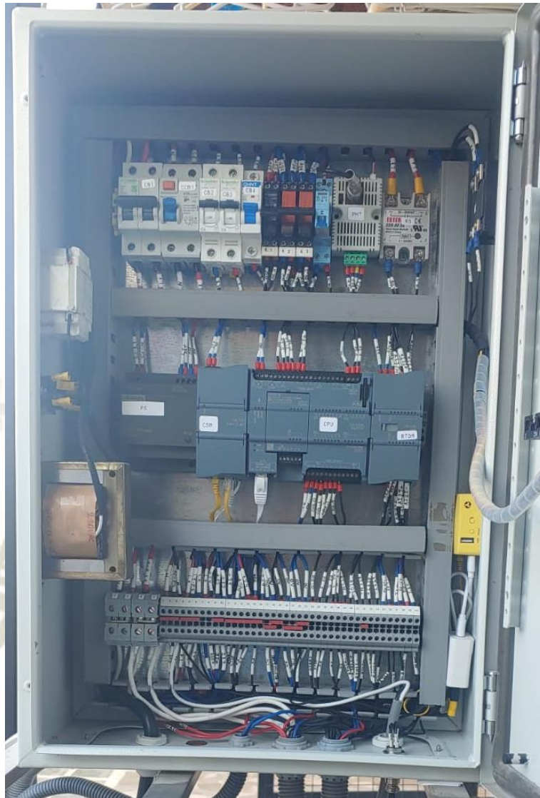
Fig. 37. Vista del interior del tablero eléctrico
