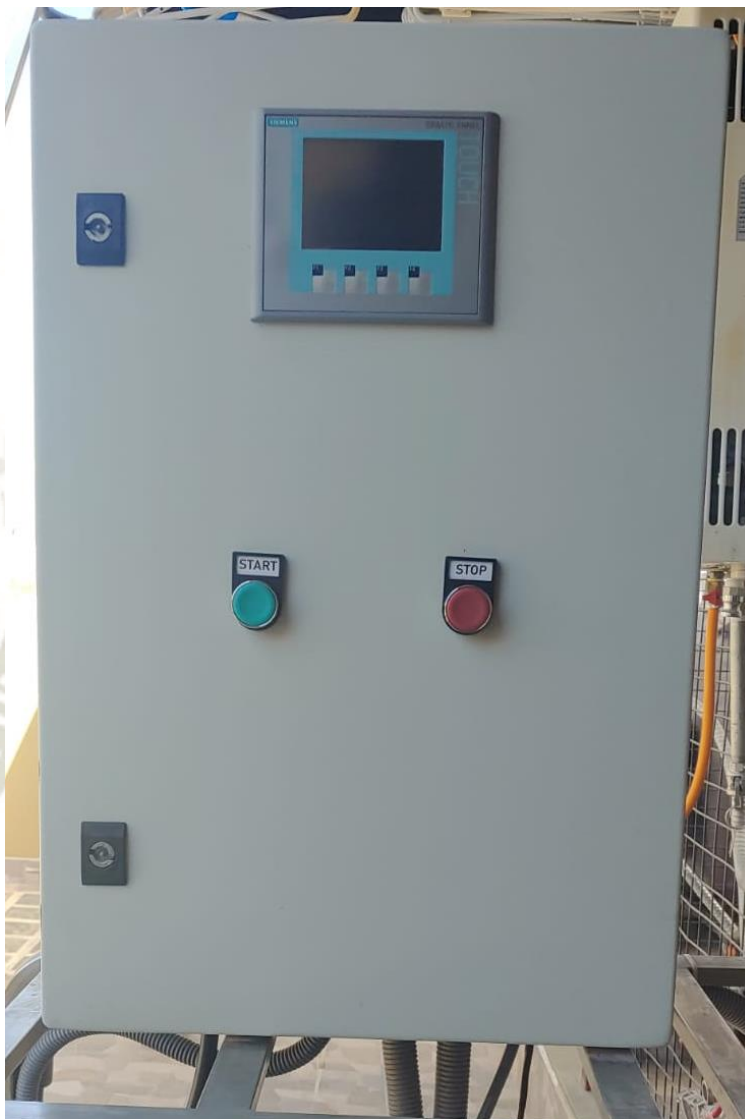
Fig. 36. Vista frontal del tablero eléctrico
