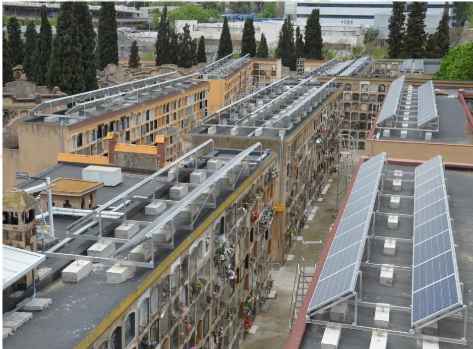
Figura 46 – Fotografía del Sistema FV del cementerio de Les Corts.
