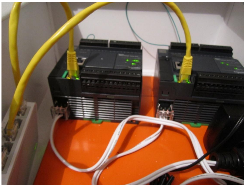
Fig. 5.2 PLC's conectados a través del cable Ethernet
