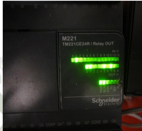
Fig. 5.23 Respuesta del PLC a alarma de intruso encendida.
