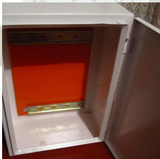
Fig. 3.97 Vista interior del módulo central de control
