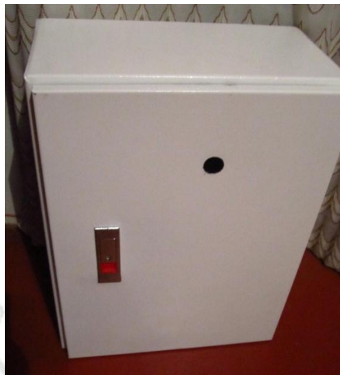
Fig. 3.96 Vista exterior del módulo central de control
