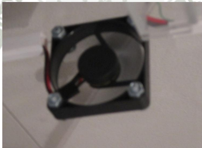
Fig. 5.13 Ventilador de Humo encendido.
