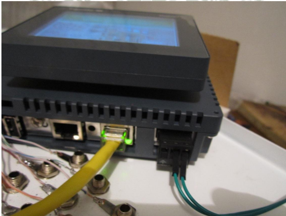
Fig. 5.1 HMI conectado a través del cable Ethernet
