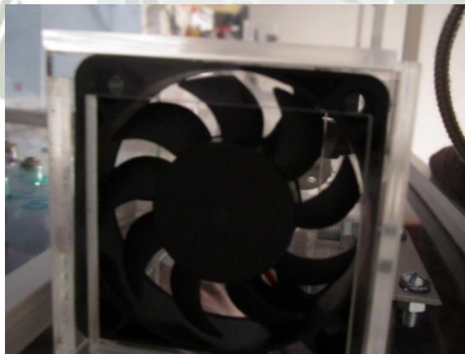
Fig. 5.18 Ventilador de calefactor apagado.
