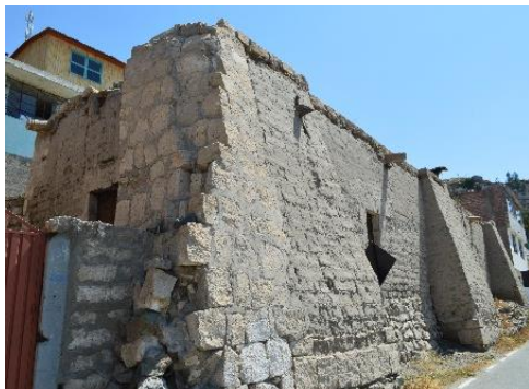
Ilustración 11 Arquitectura Vernácula en el Sector de "Pasos del Señor" (Fuente: Fotografía Propia)
