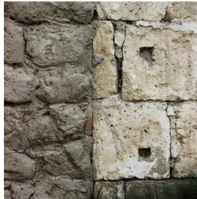
Encuentro de muro tipo cajón de sillar blanco con muro de adobe sin estuque, el adobe mide 0.20 cm. de alto. No presenta dentado por ser nuevo el muro de adobe
