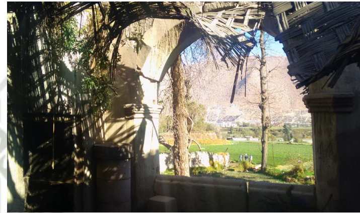
Ilustración 117 Estado actual del hecho arquitectónico patrimonial
