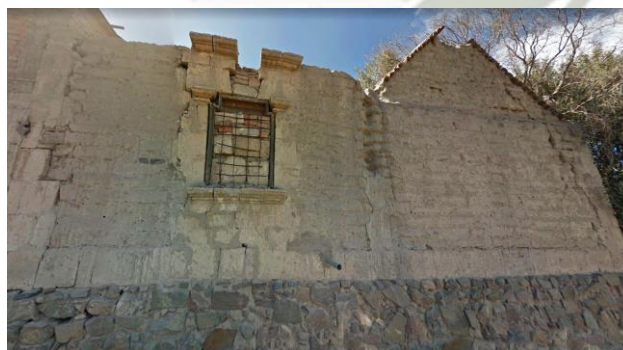
Ilustración 111 Arquitectura Vernácula en el Sector de “La Aparecida” en Sachaca, a escasos metros de una habitación urbana residencial “La Planicie” en área agrícola.
