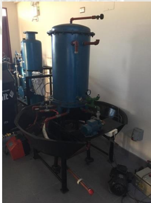
Figura 23. Módulo de trampas de vapor
