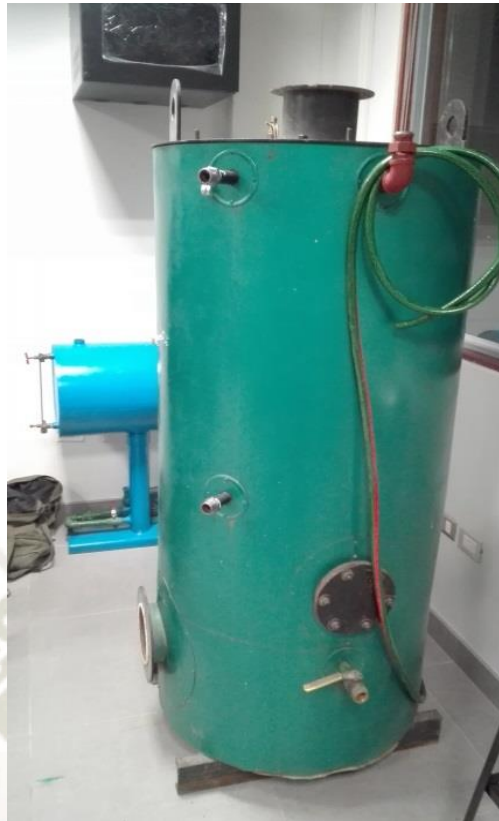
Figura 22. Caldera Pirotubular de 7 CV
