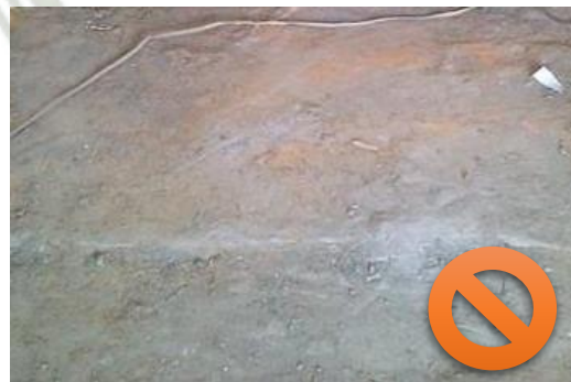
Piso desnivelado: Incorrecto
