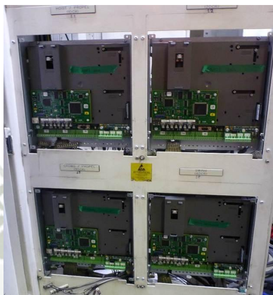
Fig. 6.24 Drives de Armadura
