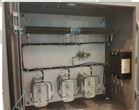
Fig. 6.4 Gabinete de Supresores del transformador auxiliar.
