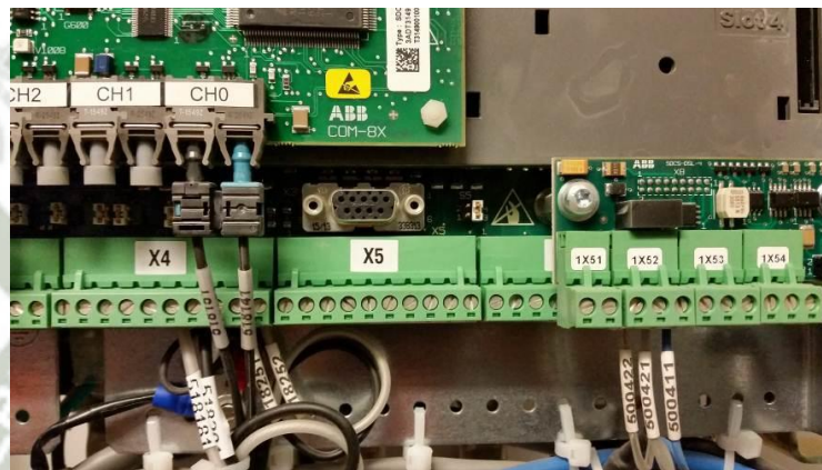
Fig. 6.17 Verificación de las fibras ópticas en los Drives DCS800
