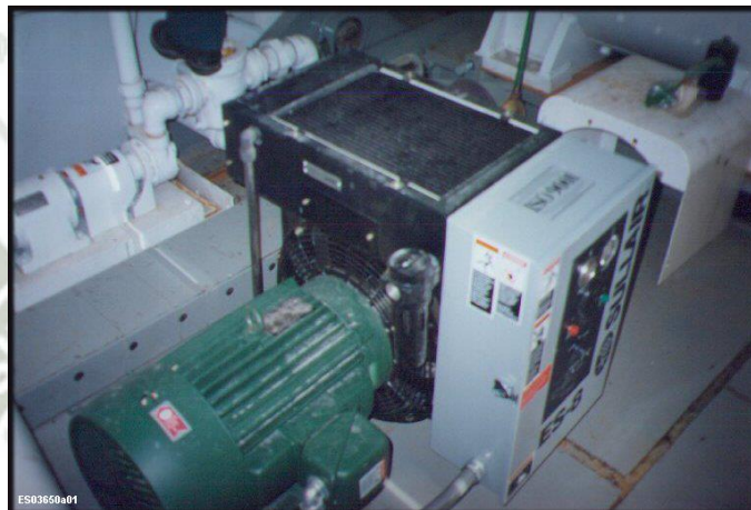
Fig. 3.20 Compresor de aire
