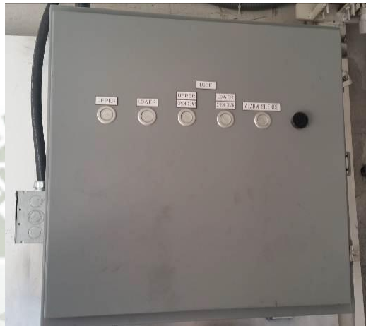
Fig. 6.3 Gabinete de I/O de Lubricación
