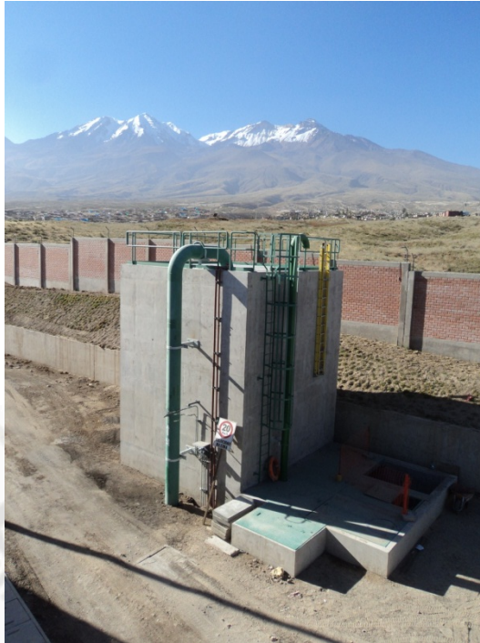
Foto 5.10: Cámara Rompe Presión
