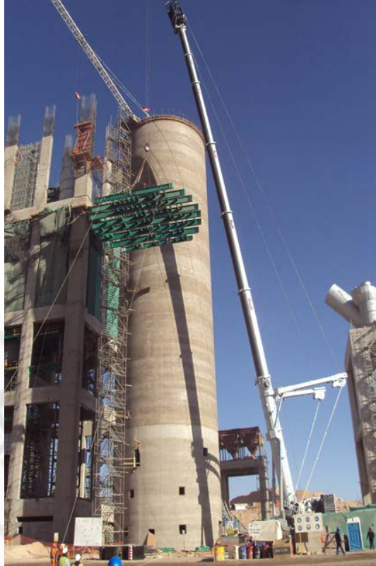
Foto 4.24: Losa Colaborante Superior
