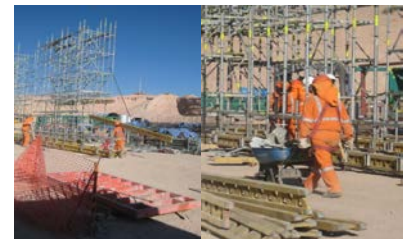
ACARREO MANUAL: Actividad contributoria inadecuada cuando los puntos de acopio de material están bastante alejados del área de trabajo del habilitado
