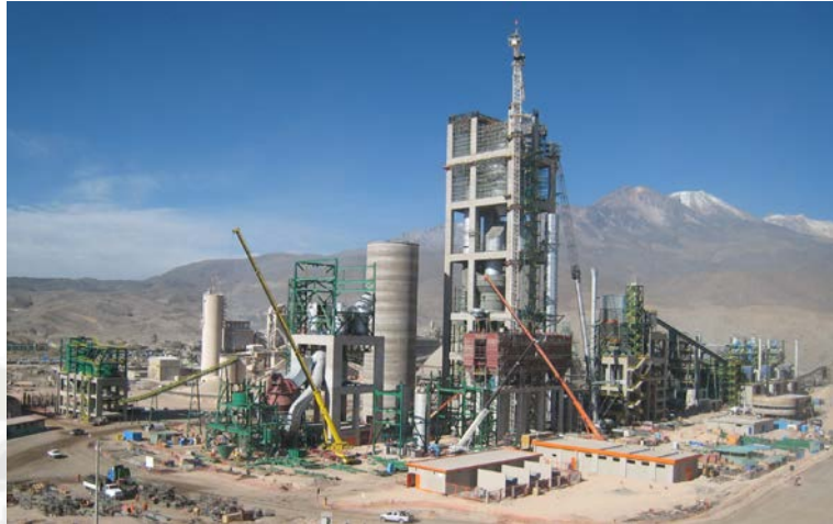
Foto 4.1: Foto Panorámica de Ejecución de 3ra línea de Producción de Clinker de Yura
