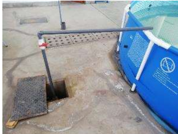
Fotografía N° 11.- Punto de alimentación
