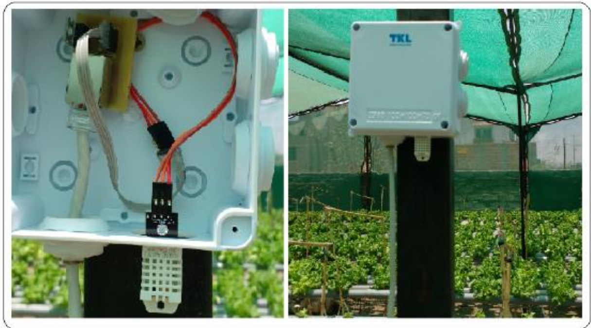
Figura 5.8. Implementación del sistema de medición de la humedad y temperatura de ambiente Fuente: (Elaboración propia)
