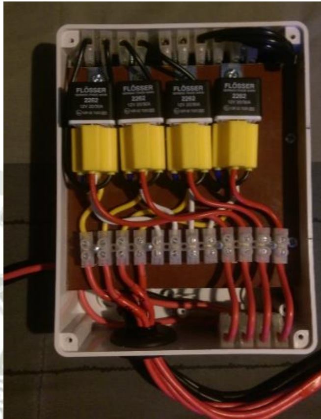
Figura 45. Tablero eléctrico del módulo peltier
