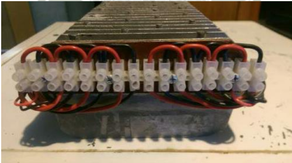
Figura 42. Bornera eléctrica y conexionado de cables.
