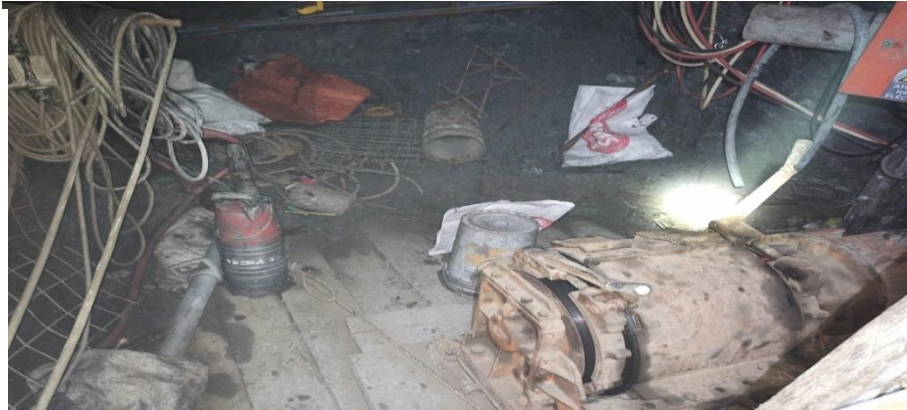
Cámara de Winche rastrillaje – Sub nivel delicias 0
