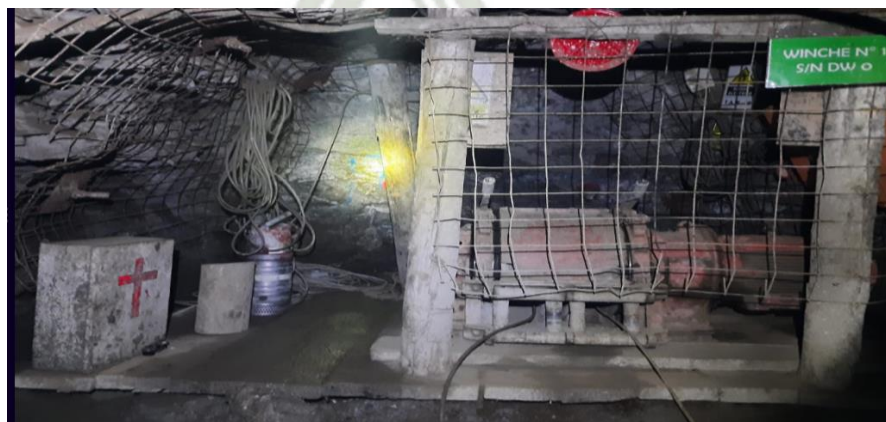
Cámara de Winche rastillaje – Sub nivel delicias 0
