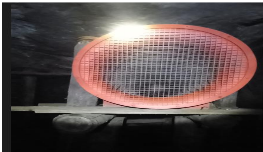
Ventilador subnivel 7 (sindw-7)
