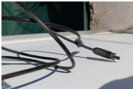
Figura 81. Conectores de paneles solares.
