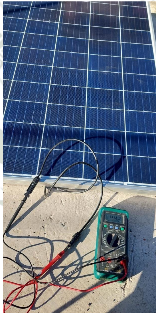
Figura 82. Medición de voltaje sin carga.
