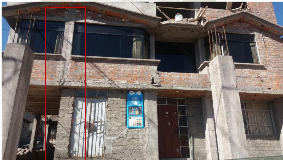
Figura 10: Ejemplo 6 de vivienda con errores constructivos.
