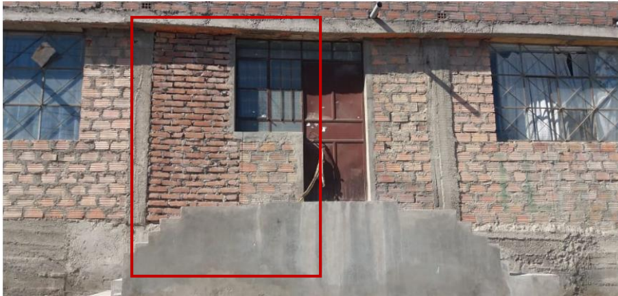
Figura 6: Ejemplo 2 de vivienda con errores constructivos.
