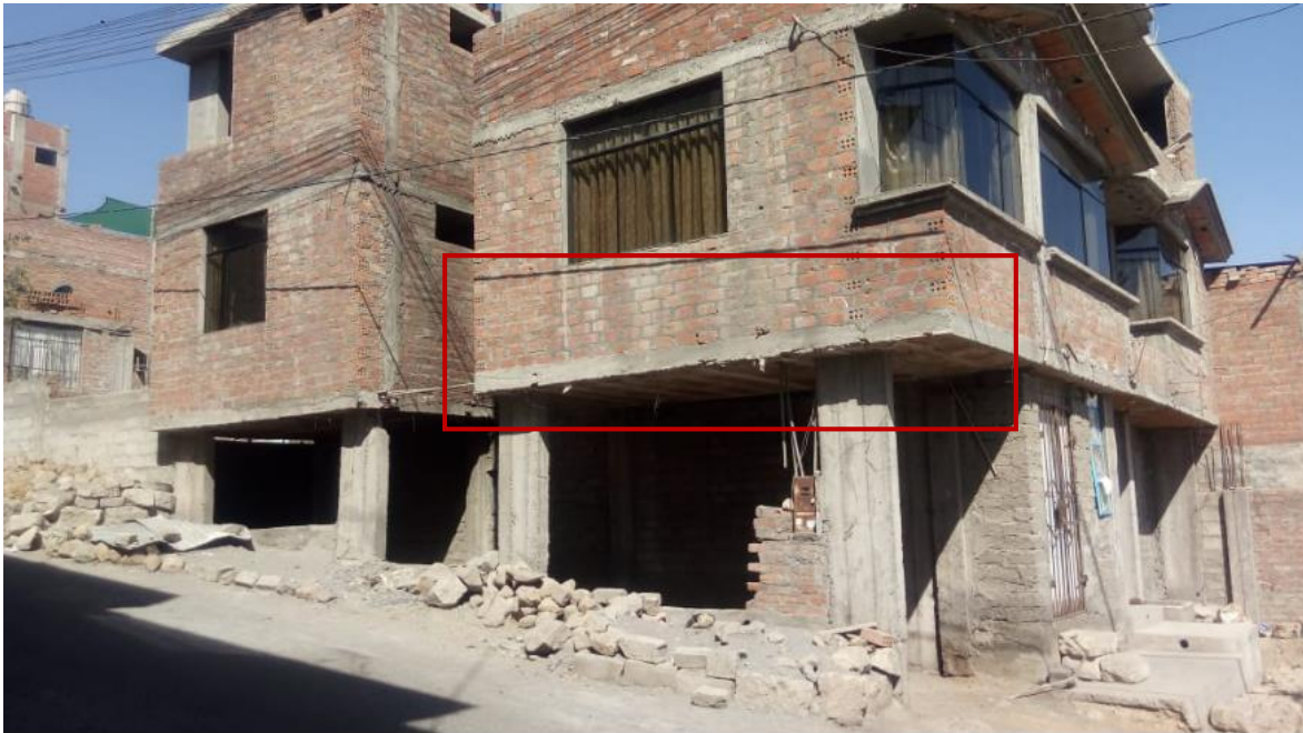
Figura 13: Ejemplo 10 de vivienda con errores constructivos.
