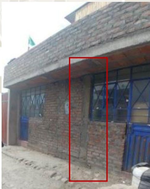
Figura 5: Ejemplo 1 de vivienda con errores constructivos.
