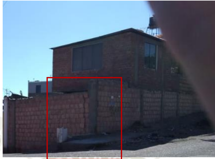
Figura 14: Ejemplo 11 de vivienda con errores constructivos.
