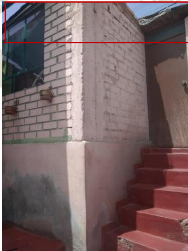
Figura 7: Ejemplo 3 de vivienda con errores constructivos.
