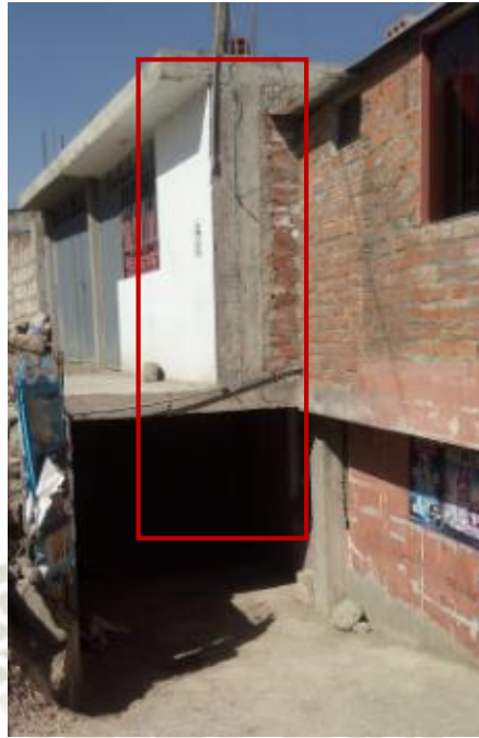
Figura 9: Ejemplo 5 de vivienda con errores constructivos.
