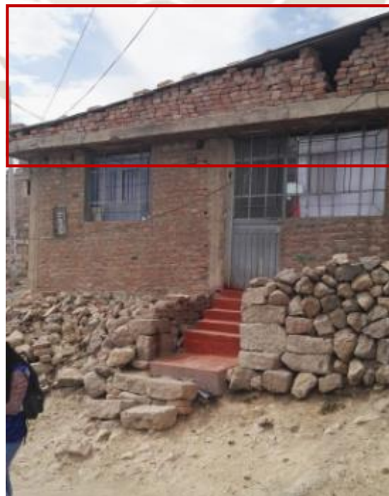
Figura 12: Ejemplo 9 de vivienda con errores constructivos.
