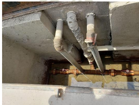
Figura 43: Sistema de salida del tratamiento primario (sedimentación) de la PTAP de Quequeña
