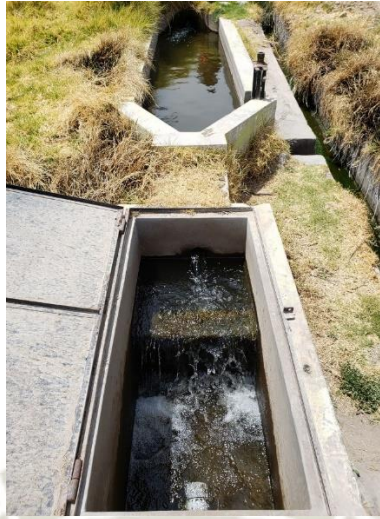
Figura 41. Canales de inicio del Sistema y proceso de cribado de la PTAP de Quequeña
