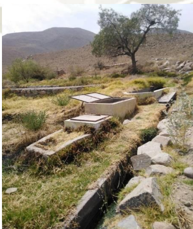
Figura 40. Inicio del sistema de tratamiento de la PTAP de Quequeña
