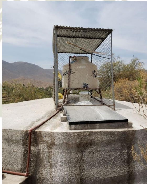
Figura 45: Tanque de dosificación de cloro para el reservorio de agua
