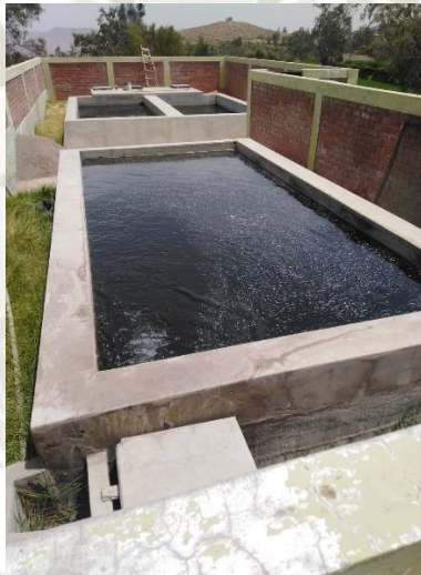
Figura 42: Pozos de tratamiento primario de filtración de la PTAP
